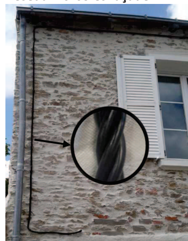
Réseau fils isolés façade BT
