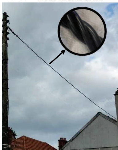
Réseau fils isolés aérien BT
